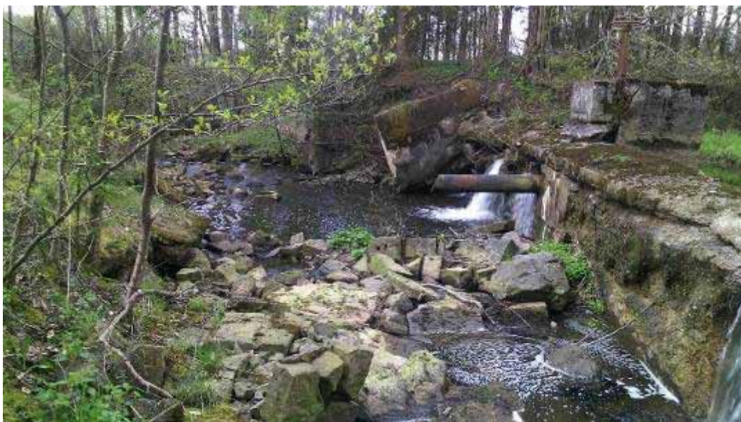
Obrázek 12.7. Betonový přeliv včetně vypouštěcího zařízení a vývar ve velmi neuspokojivém stavu
