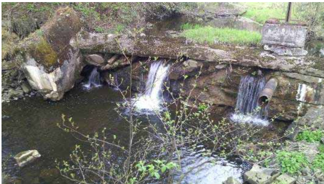
Obrázek 12.6. Zcela zničený betonový přeliv včetně vypouštěcího zařízení
