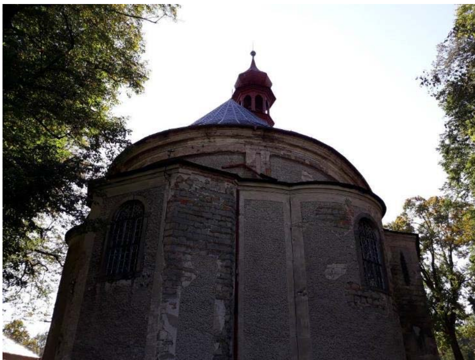
Obr. 27 Zadní strana kostela je již značně poškozena
