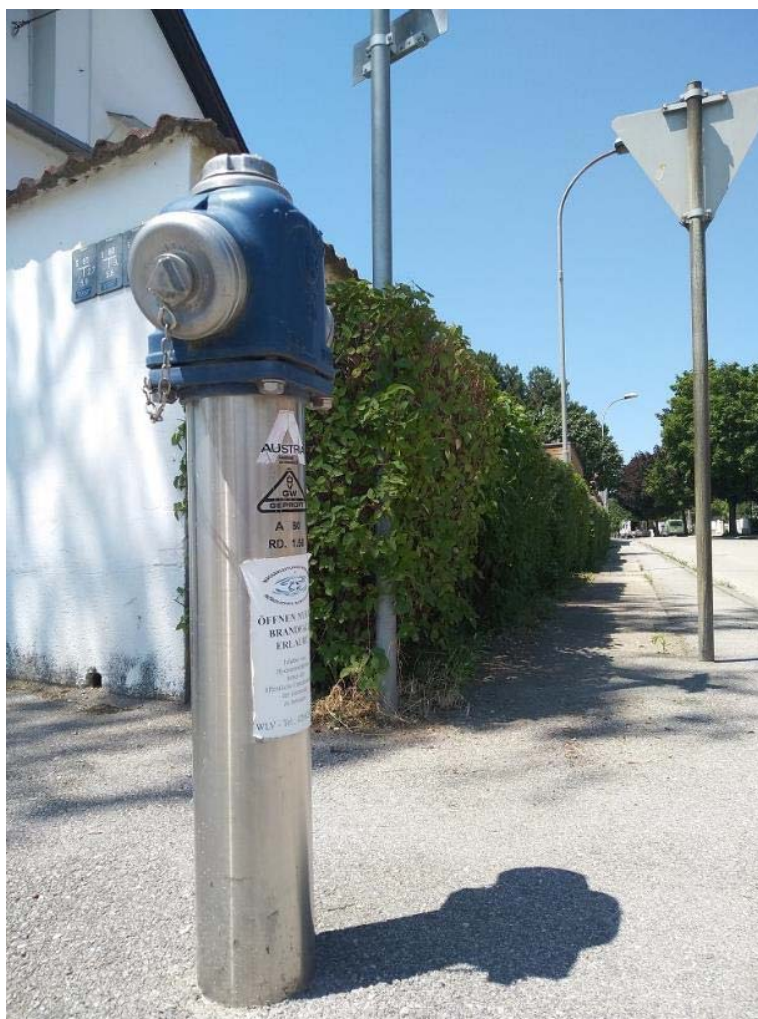
Obr. 134 Hydrant v obci
